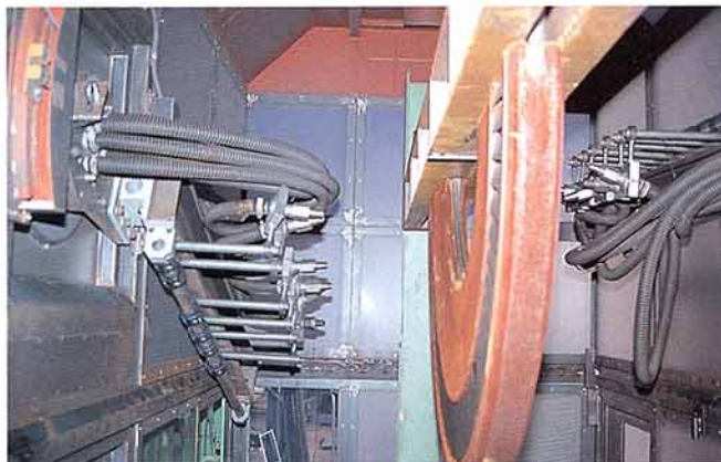
写真-3 清掃前のブラスト室の状況
