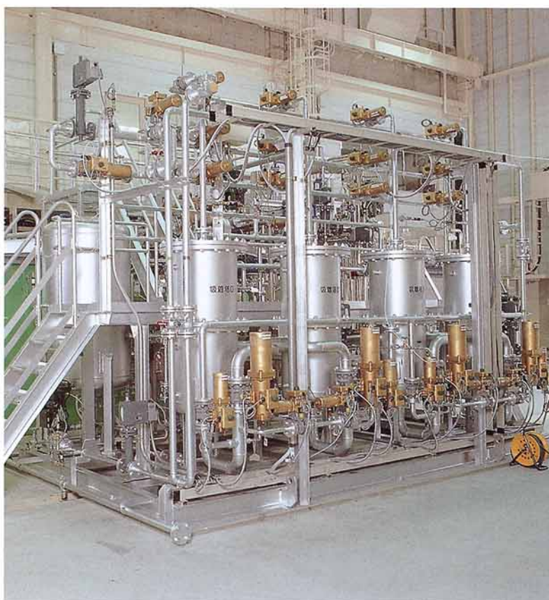
第4図 CO 2 分離回収試験装置
