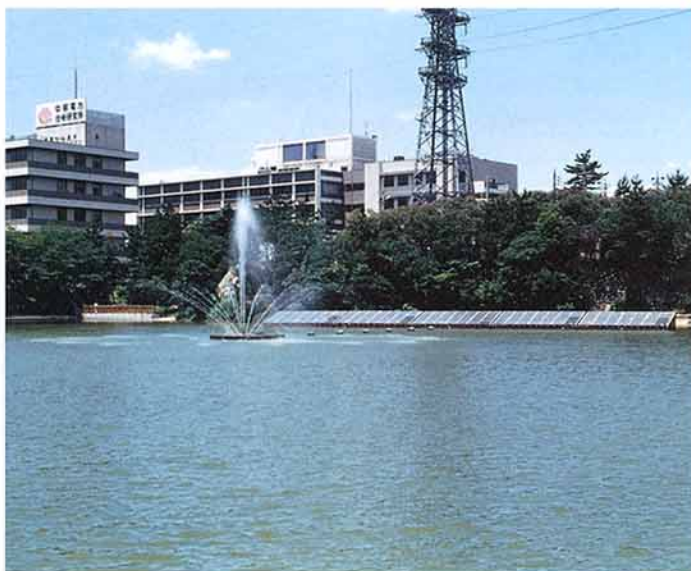
溜池水面に設置した太陽光発電噴水システム
