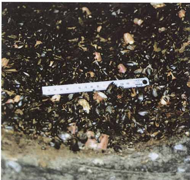
第4図 作業前の配管内面状態
