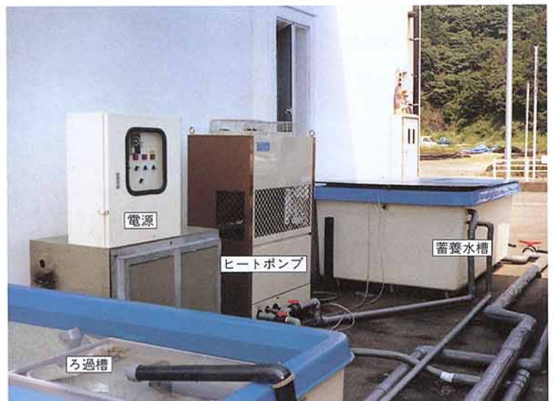
第4図 実験装置（ヒートポンプと蓄養水槽）
