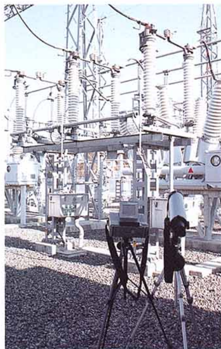
第1図 気中断路器とサーモカメラ
