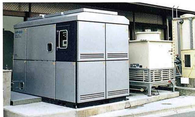
写真 電力技術研究所50kW機
