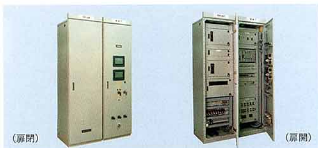
第3図 全機能一体形制御保護装置
