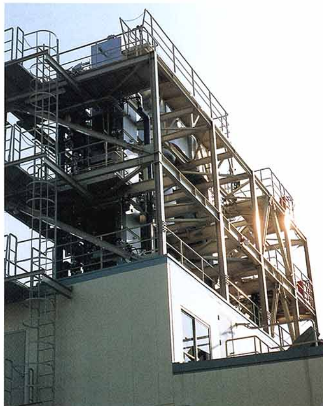
循環流動床燃焼炉
