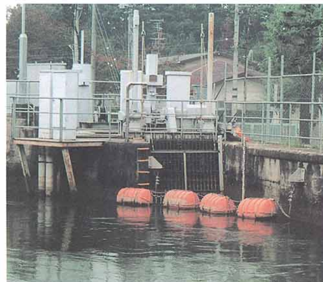
第7図 簡易型迷入防止装置設置状況
