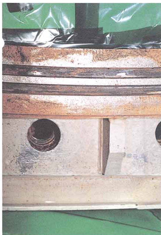
第3図 清掃前のフランジ面の状況
