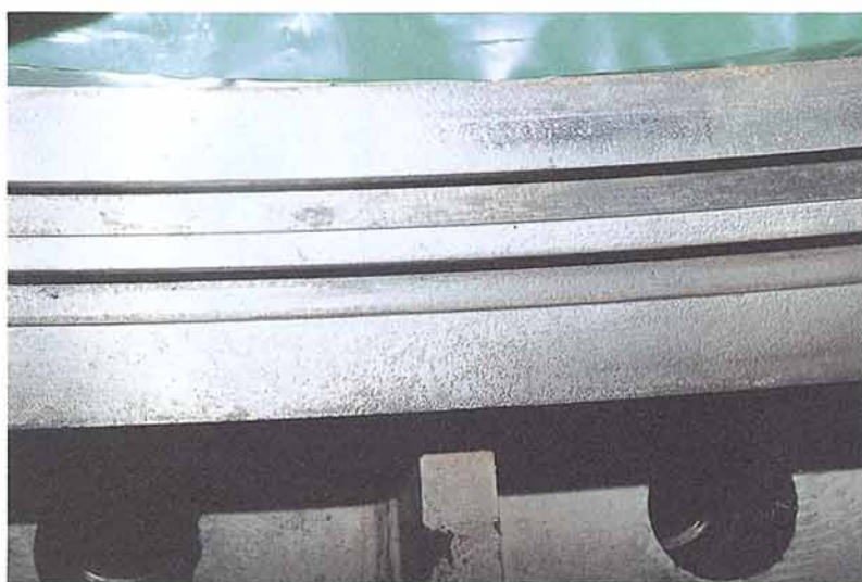
第4図 清掃後のフランジ面の状況
