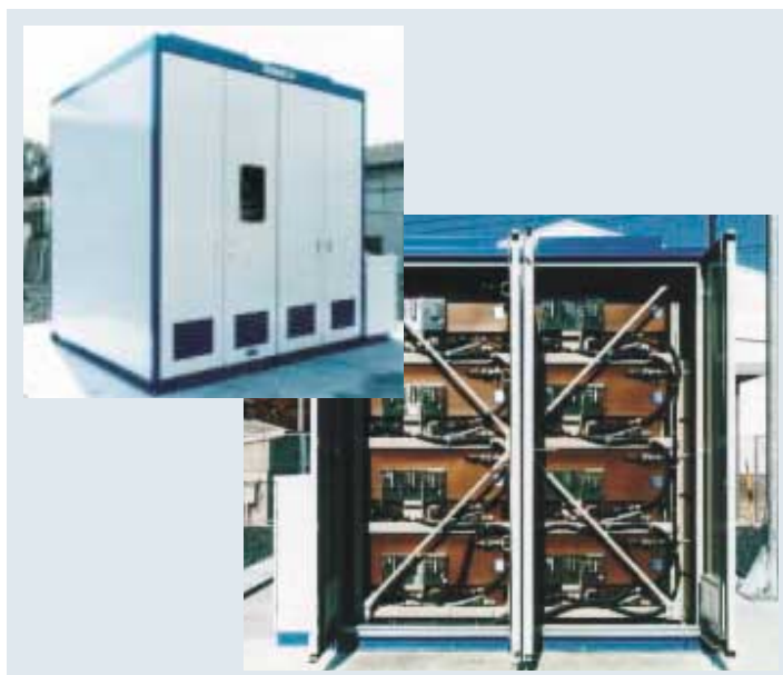
第1図 屋外電池キュービクル施設
