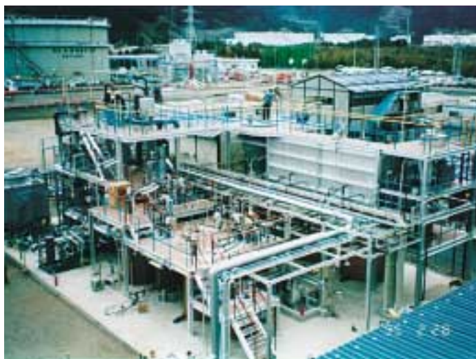
第1図 AWMT実証試験設備の全景
