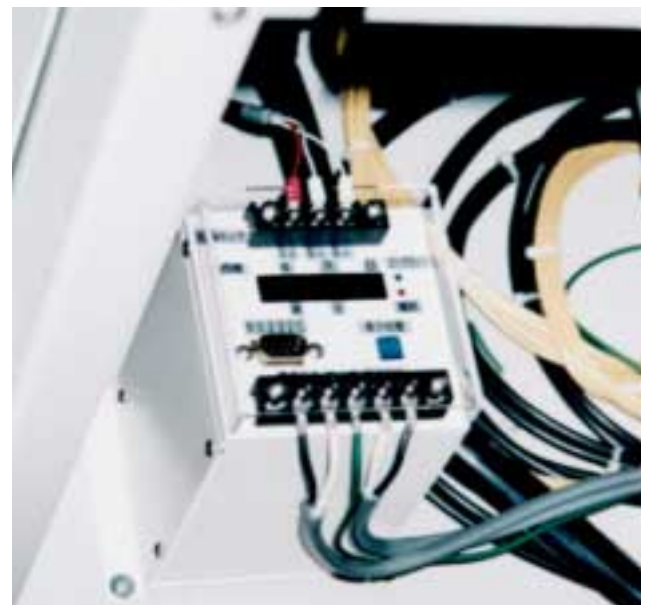
第3図 実機への取付状況
