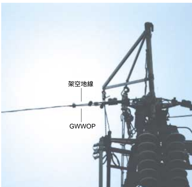
写真2 送電鉄塔頂部の巻付後の状況 (頂部には仮足場等が設置)
