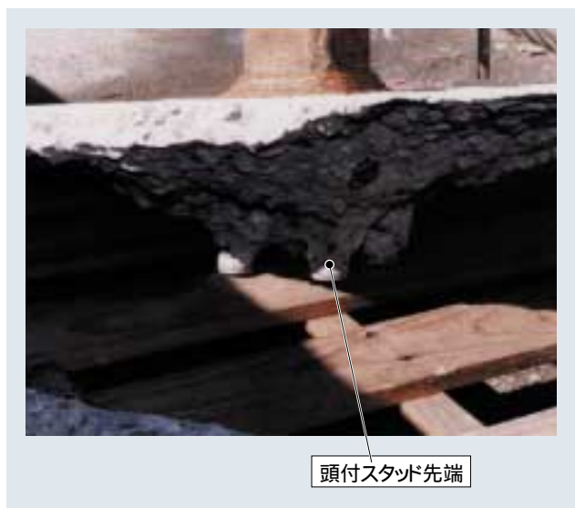
第2図 破壊状況
