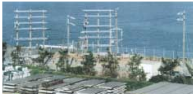
第1表 新塩害試験場の外観図と設備概要
