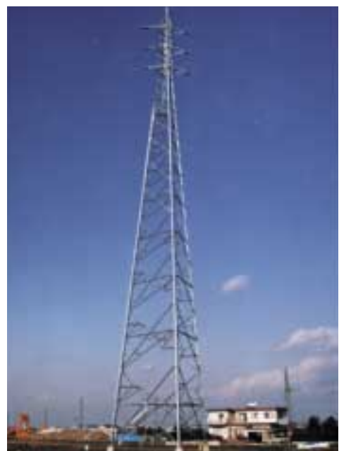
第4図 三角鉄塔(栄屋乳業矢作線 第2号鉄塔)
