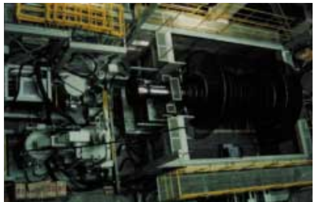
第2図 ホーニング装置据付外観
