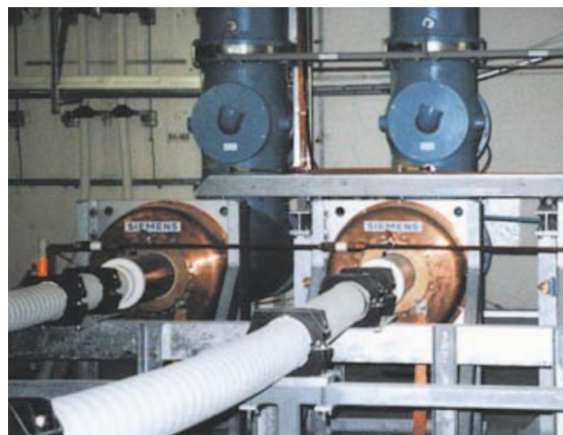
第3図 420kV/XLPEケーブルのGIS端末
