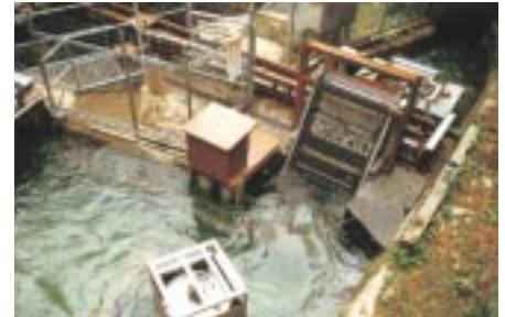
写真-3 無電源除塵機全景
