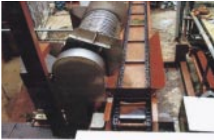
写真-2 塵芥搬出コンベヤ
