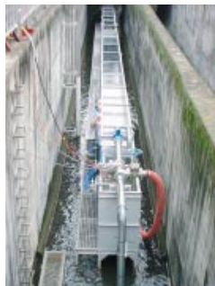
堀川実証試験水路全景
