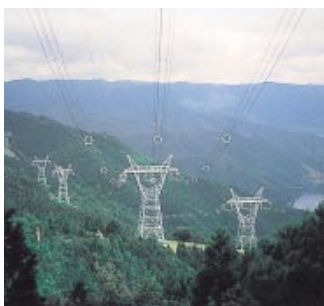
第3図 超大束径6導体送電線
