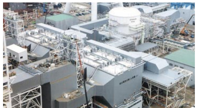
第7図 排ガス処理装置全景 (左からボイラ出口、脱硝装置、電気集じん器、脱硫装置)
