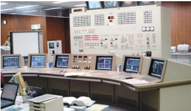
第5図 中央制御室主盤・補助盤
