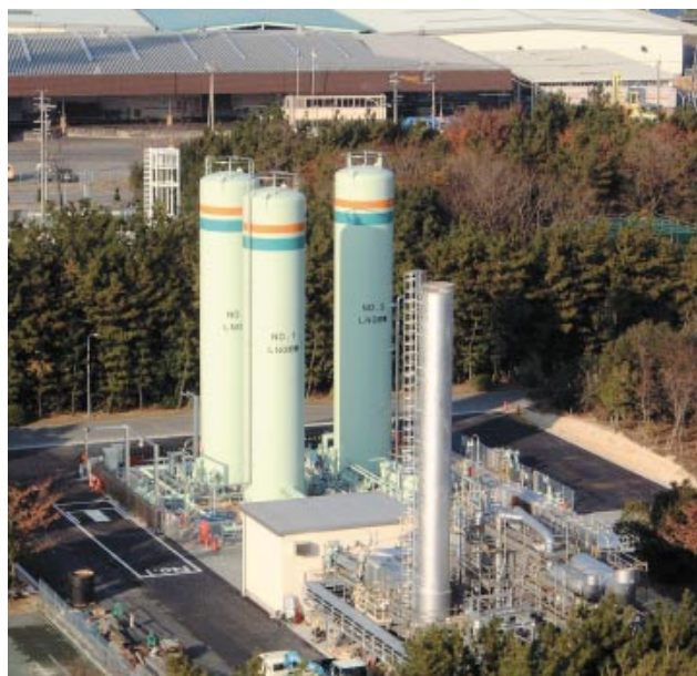
西名古屋火力発電所サテライト設備
