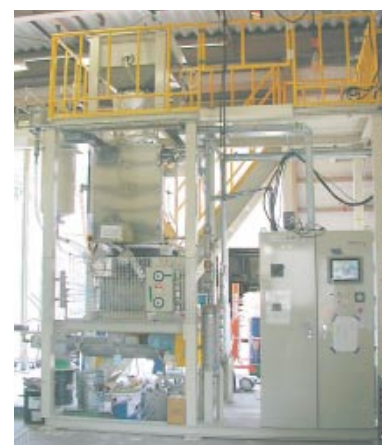
第16図 フロン破壊処理装置
