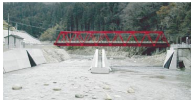
第6図 ゴム堰倒伏状況
