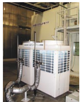
ビル用マルチエアコンの室外機
