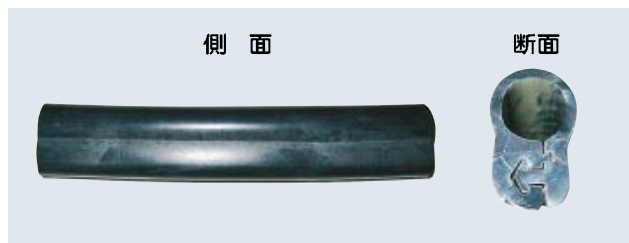
第3図 撤去品の劣化状況
