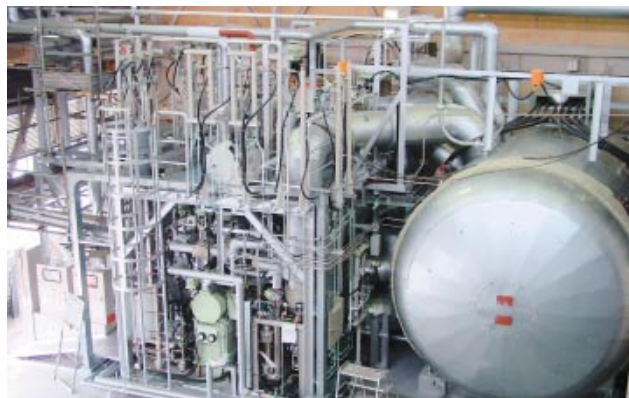
写真2 300kW級発電システム外観
