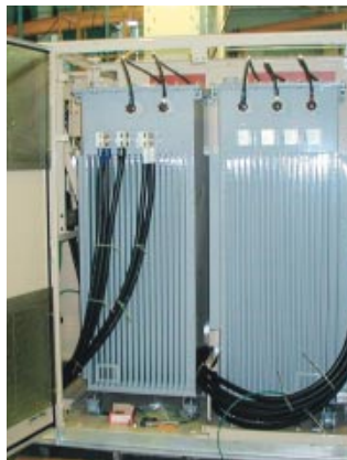
第3図 変圧器側
