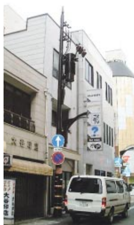
第4図 街路灯柱設置型変圧器
