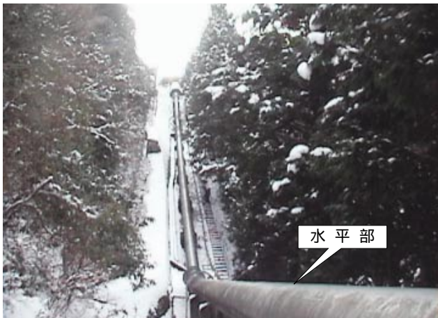
第1図 千草発電所水圧鉄管
