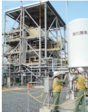
バイオマスガス化メタノール製造パイロットプラント
