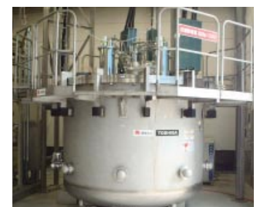
シャープ（株）亀山工場殿においてフィールド試験中のSMES
