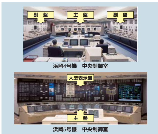
第8図 中央制御室新型監視制御システム
