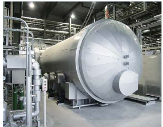
第7図 MCFC据え付け状況
