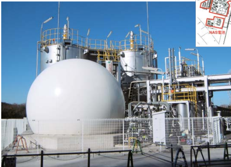
第5図 メタン発酵槽(後方)およびガス調整器(手前の球形物)
