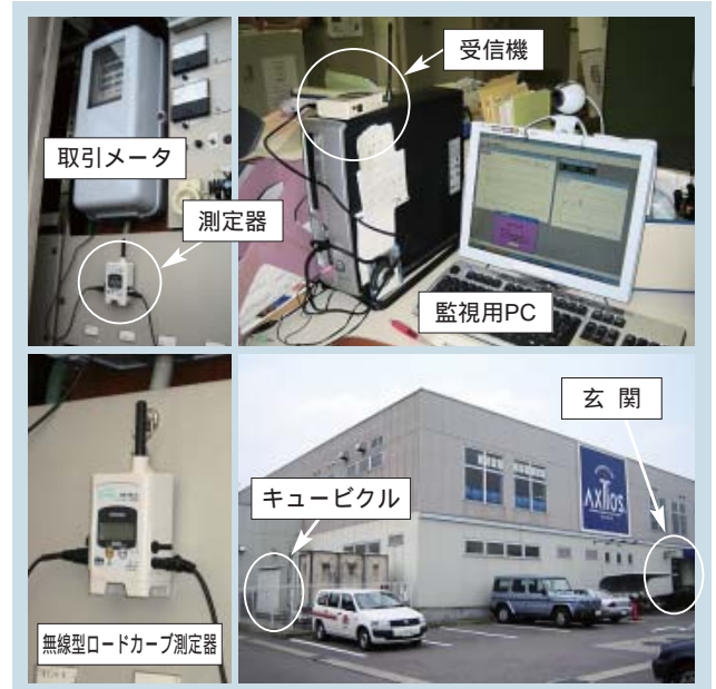
第4図 (株)アクトス岐阜店さま設置状況
