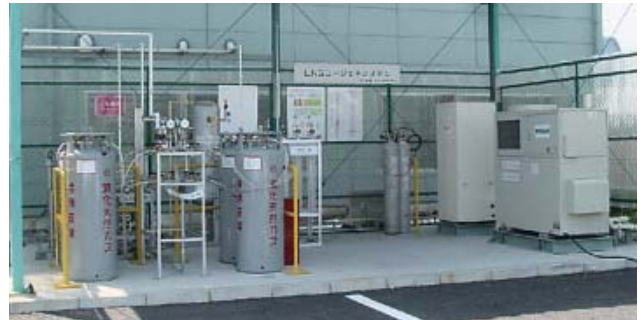
ポンプ供給LNGによるコージェネ実験設備
