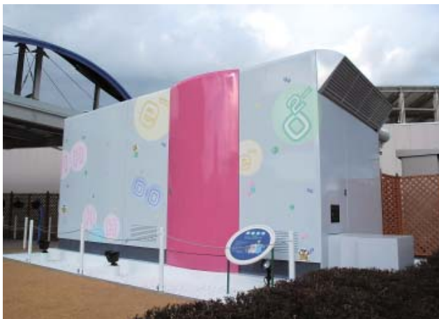
第1図 電力館前庭に設置したSOFC実証設備
