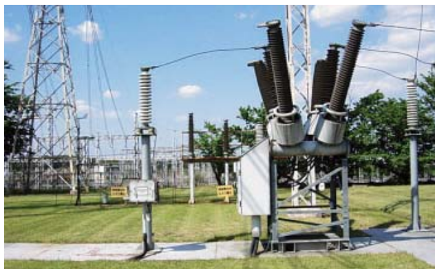
第1図 ポリマー罅管付きガス遮断器設置状況
