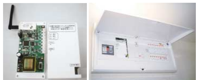
第3図 電力量測定ユニット及び分電盤での取付状況
