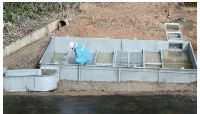
写真3 石川県羽咋市射撃場の浄化システム
