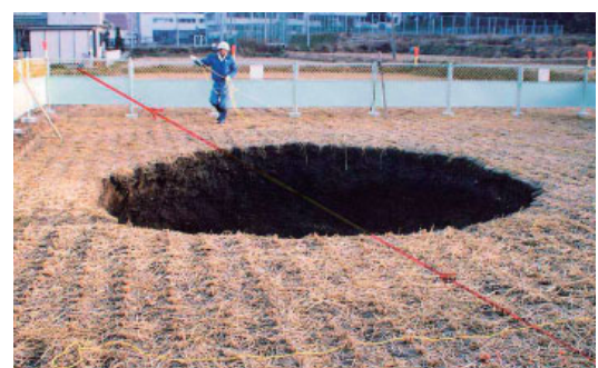
写真-2 地表面陥没事例
