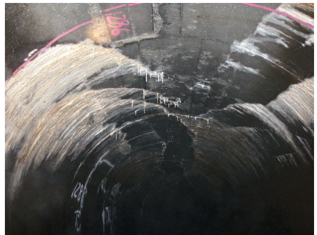
写真-3 変状の一例
