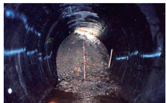
写真-1 水路閉塞事例
