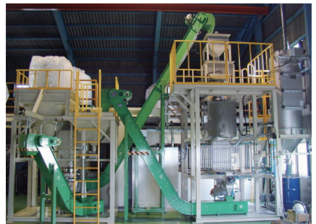
フロン・六フッ化硫黄無害化処理装置
