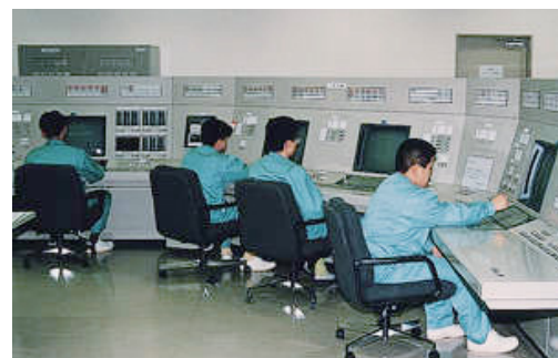
第3図 六ヶ所ウラン濃縮工場の中央制御室 2
