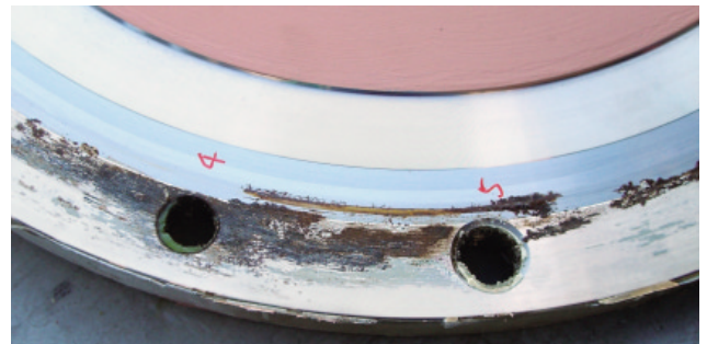
第2図 フランジ腐食状態
