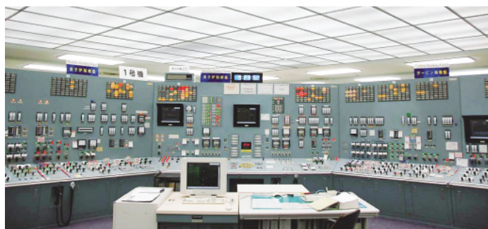
SRNM予測手法の検証試験が行われた 浜岡原子力発電所1号機中央制御室
