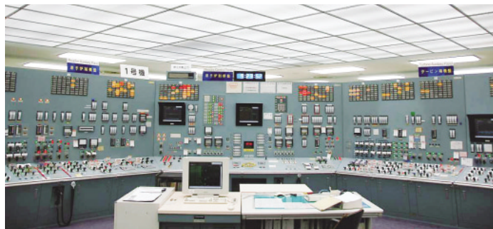
SRNM予測手法の検証試験が行われた 浜岡原子力発電所1号機中央制御室
