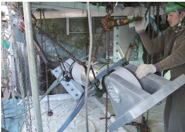
第5図 既設橋梁下部でのダンパー移動作業状況(井川ダム)
