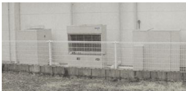
左から空調用冷凍機、冷蔵用冷凍機、統合蓄熱槽
